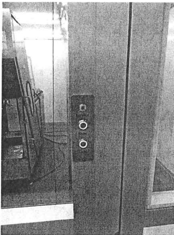
Service- Kontrollanzeige und Bedienschalter für Licht und Laminarflow
